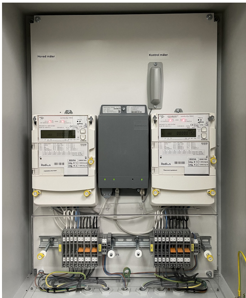
FIG 2 (Billedet viser bagplade med opbygning for klemrækker for målere, samt klemmer for 230V til kommunikationsudstyr)
