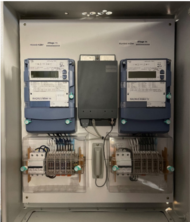
FIG 2 (Billedet viser installation med kommunikationsudstyr og spændingsautomater umiddelbart under måler)
